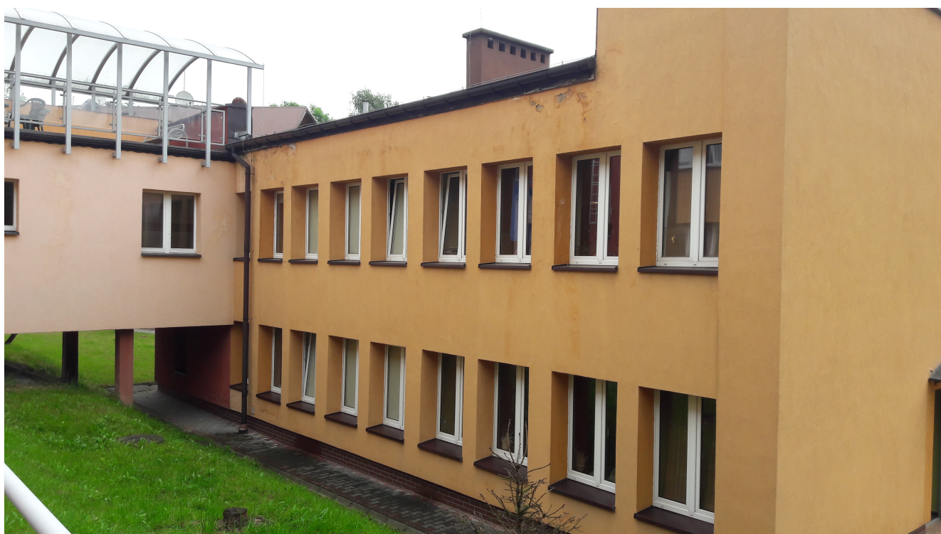
zacieki na elewacji-elewacja zachodnia
